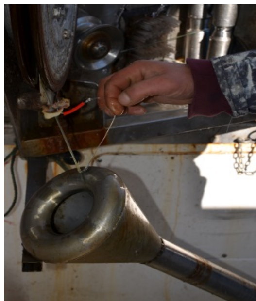
Trakt og rør står under kveileren.
