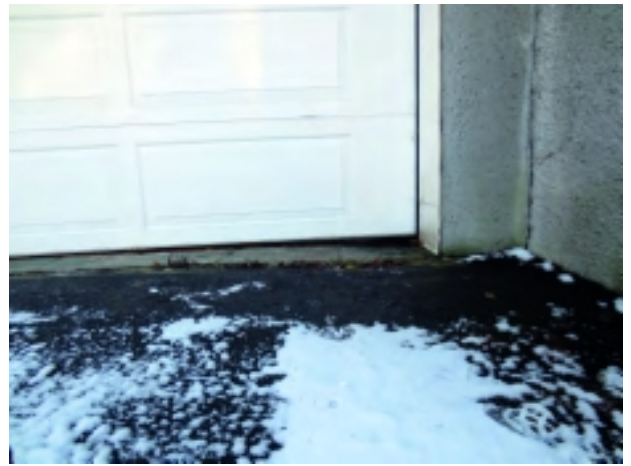
Relativt ny bolig. Betongringmuren er høyere inn mot midten, porten går ned i betongen, asfalten er ujevn, og det er sprekker i mur. Det indikerer bevegelser som skyldes tele. Foto: SINTEF Byggforsk
