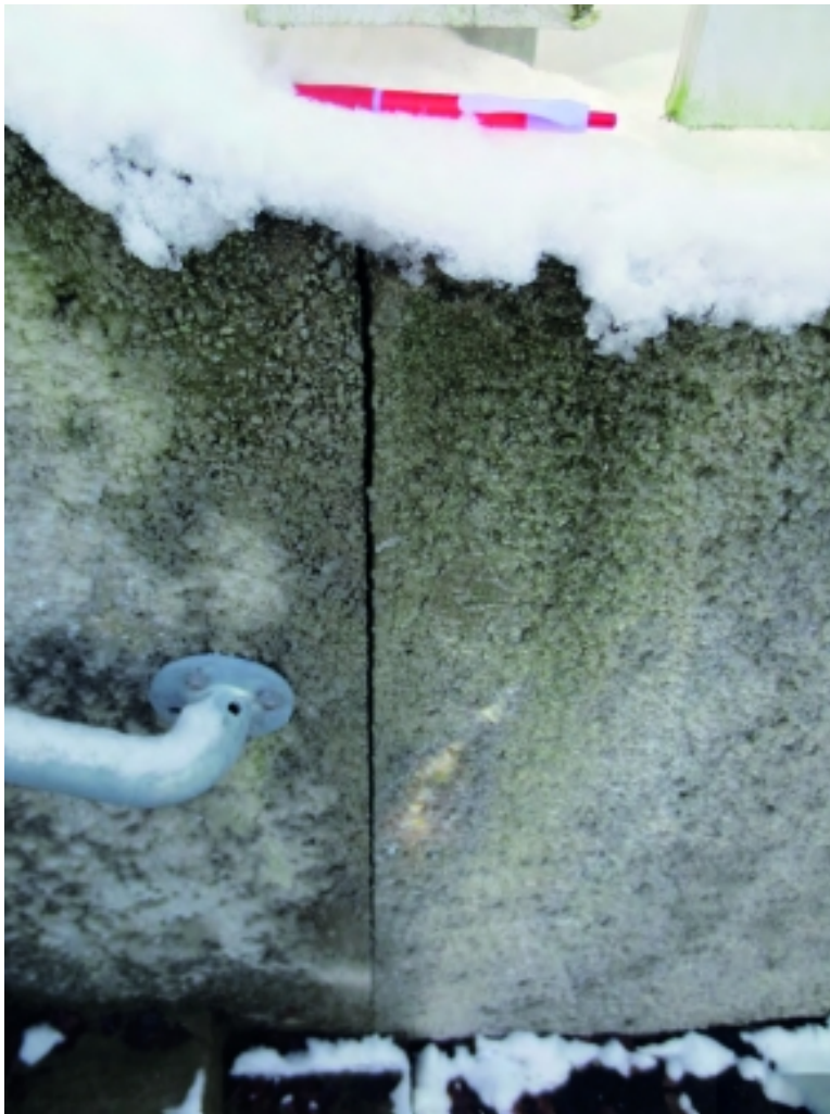
Sprekken er større øverst; det er sannsynligvis bevegelser på grunn av telepåvirkning. Foto: SINTEF Byggforsk
