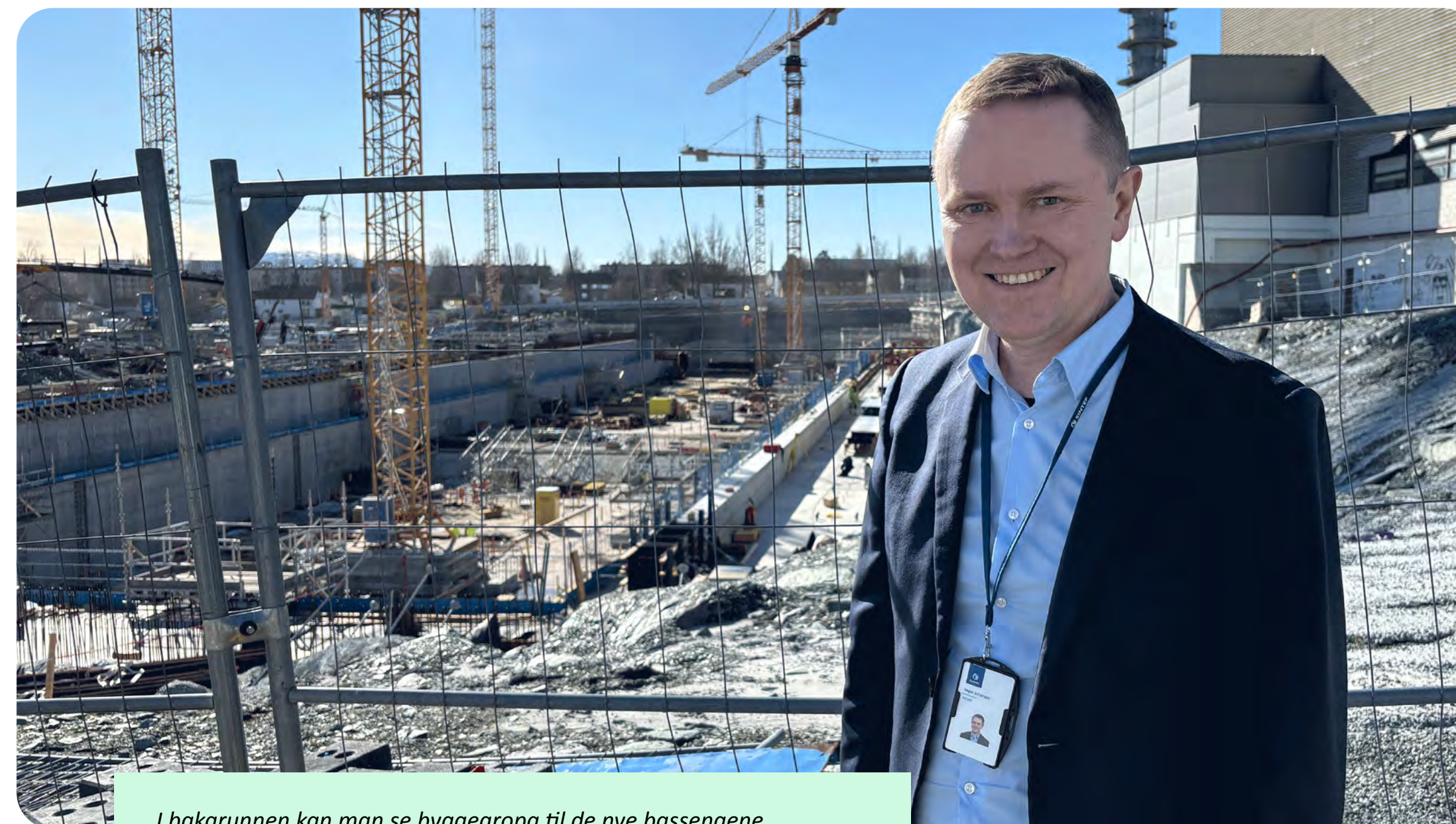
I bakgrunnen kan man se byggegropa til de nye bassengene på Tyholt, som blir en viktig del av Norsk havteknologisenter.
