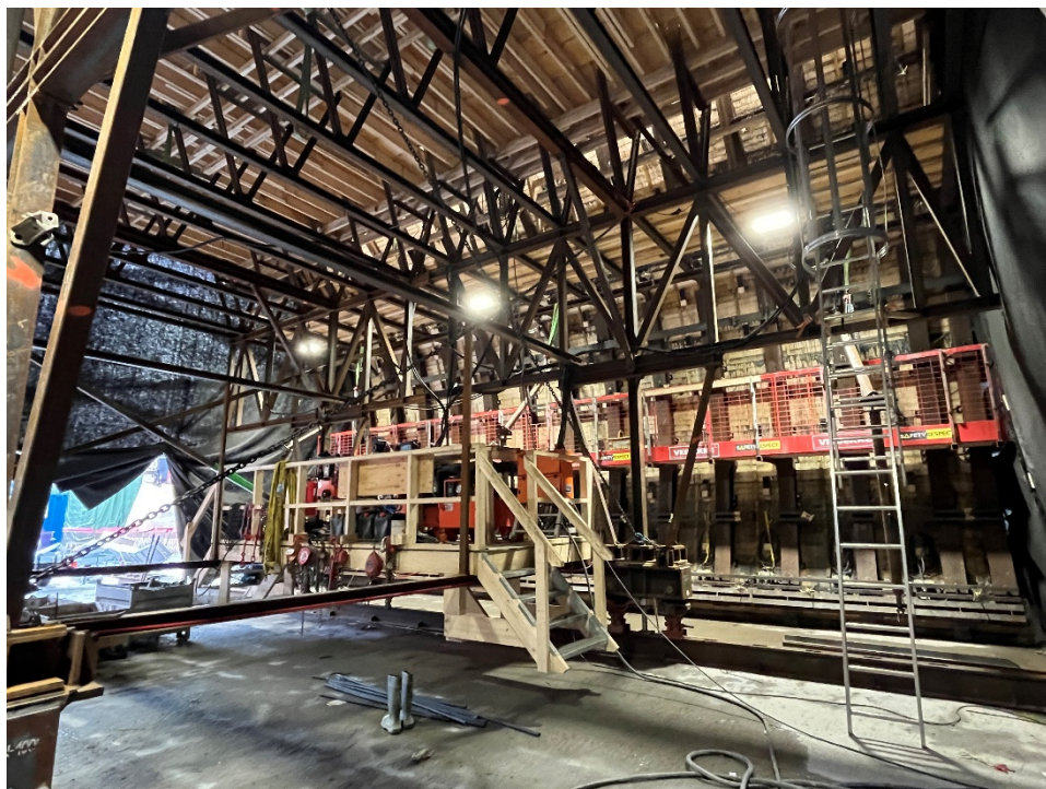
Figur 9-4: Innsiden av vognen som ble utviklet for å støpe vegger og dekke i samme støpe-etappe.
