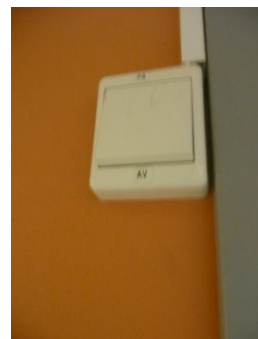
Figur 11 Bryter ved dør for å skru av og på døralarm
