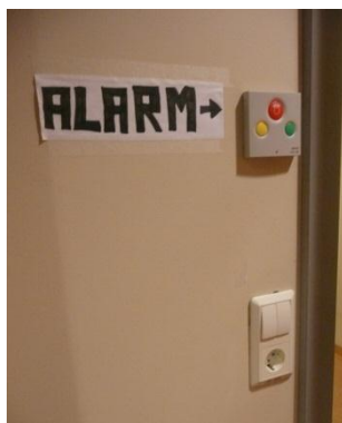
Figur 9 Alarm på rom til beboer som er plassert ved utgangsdøren. Lite tilgjengelig både for beboer og ansatte.
