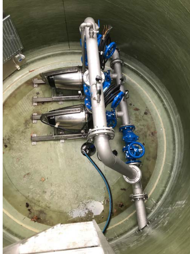
Pumpar och rörgalleri
