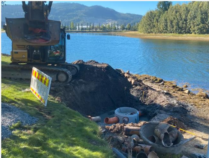
I overvannsledningen som munner ut ved Hermetikken, er det funnet høye verdier av tannbakterier. FOTO: ANDERS AASEGG MØRKEN
