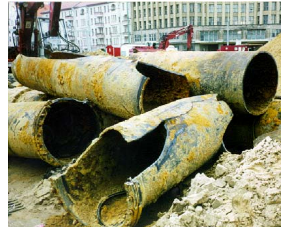
Rørbrudd grått støpejern (foto R Baur)
