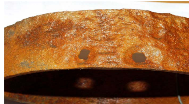
Korrosjon av metallisk rør på grunn av ugunstige forhold i ledningsgrøft (SINTEF 5 )
