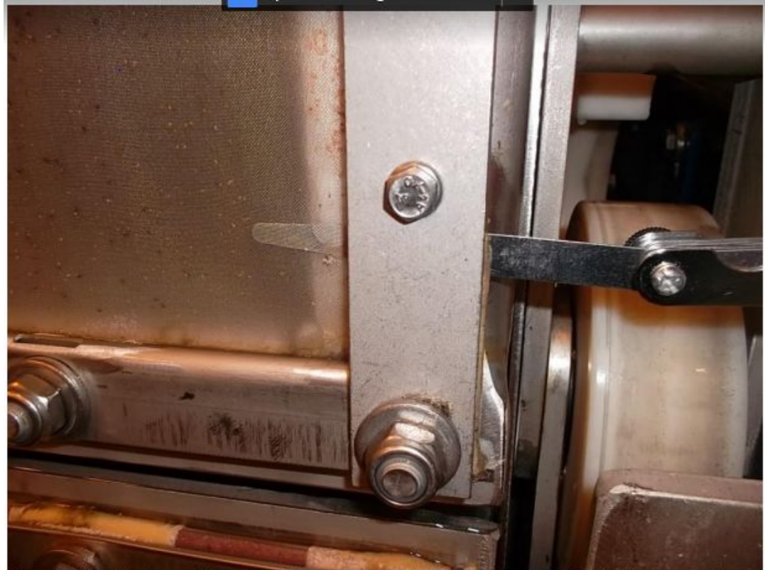
Figur 7: Viser åpning mellom filterduk og ramme. På dette bildet er det brukt bladsøker på 0.8mm.
