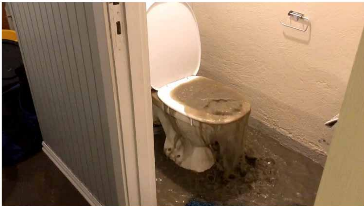
Slik så det ut i dette huset på Kvål i Melhus i natt etter flommen FOTO: KRISTOFFER SVORKÅS
