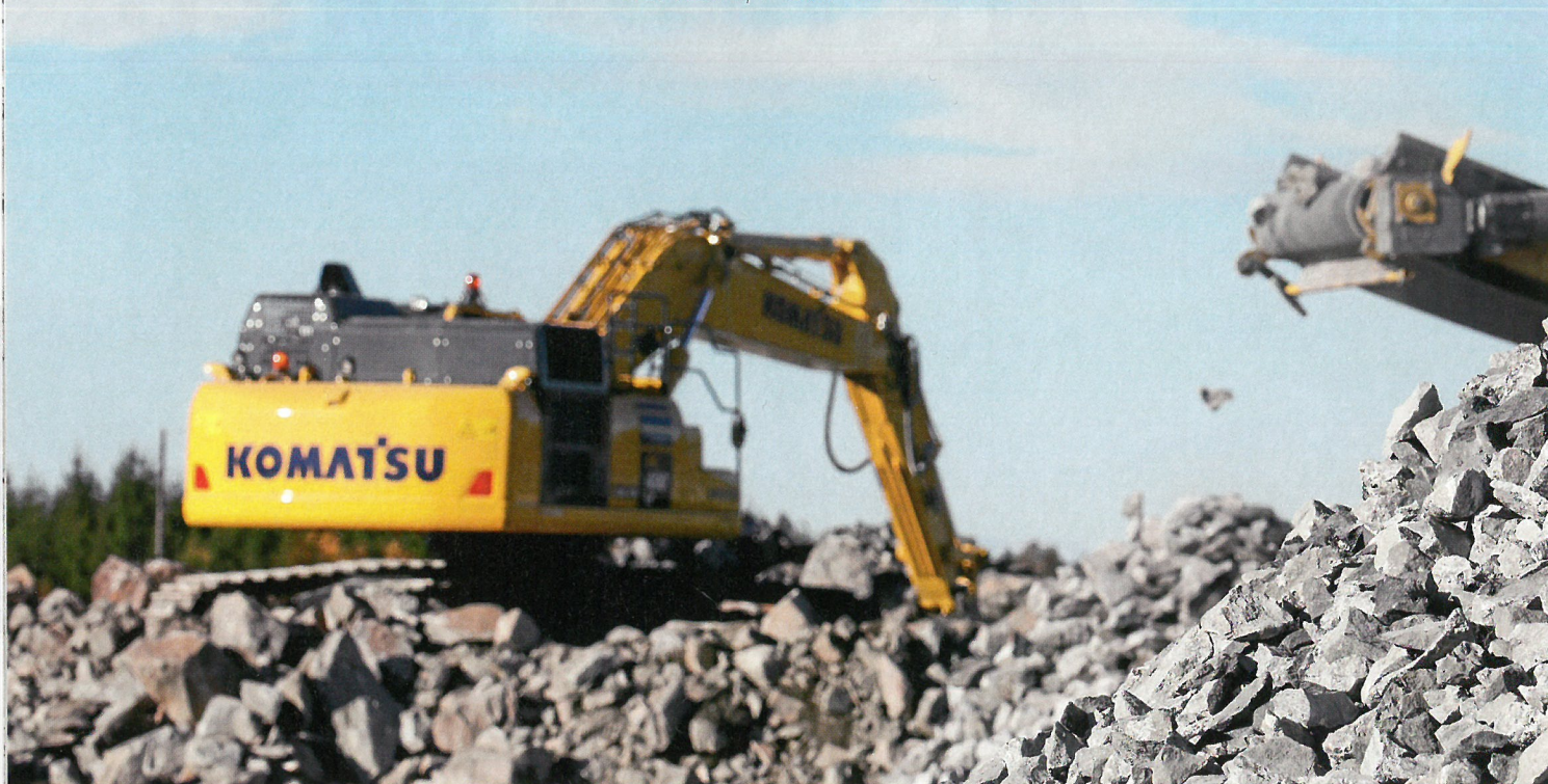
GJENBRUK: Fremfor å produsere nye masser og transportere inn til store anlegg, bør man se på hvilke muligheter som finnes for å gjenbruke eksisterende masser. Illustrasjonsbilde: Klaus Eriksen
