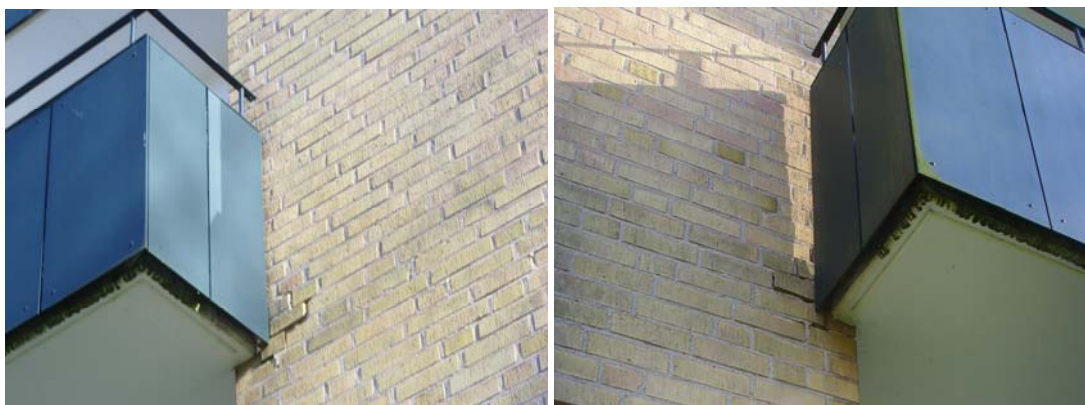
Figur 4.6 Sättningar vid balkonger
