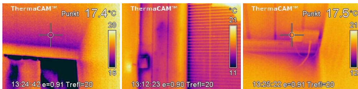
Figur 2 Innvendig termografering indikerer betydelig kuldebro i overgangen mellom taket og sør fasaden (venstre). I overgang mellom gulv og yttervegg ble det også registrert svært lave overflatetemperaturen, spesielt i forbindelse med elektriske koblingsbokser/brytere (midten). Disse lave temperaturene kan ha sin årsak i en kombinasjon mellom kuldebroer og utettheter i forbindelse med innspenn mellom innervegg-yttervegg/gulv-yttervegg, samt de elektriske installasjonene.
