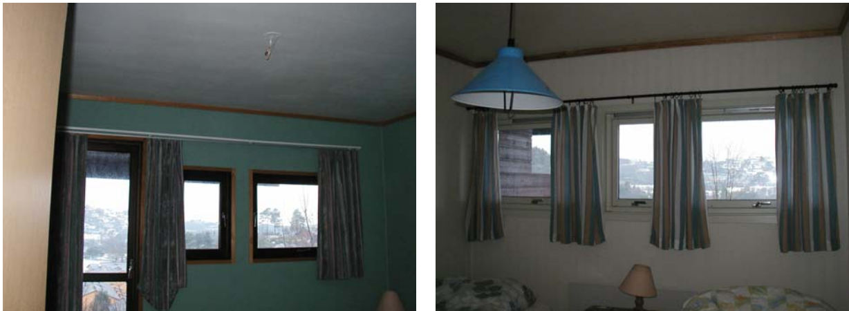
Figur 5. Frisklufttilførsel til soverom. Til venstre: Åmundsleitet 35, soverom i underetasje, opprinnelige vinduer uten spalter, ingen friskluftventil i yttervegg. Til høyre: Åmundsleitet 35, soverom i underetasje, nyere vinduer fra 1991 med luftspalter, ingen friskluftventil i yttervegg. (Foto: Sintef Byggforsk / Catherine Grini)
