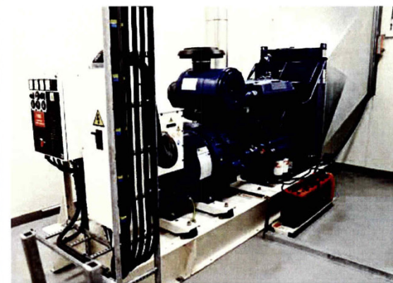
Dieselgenerator gir strøm ved lengre avbrudd fra nettet.
