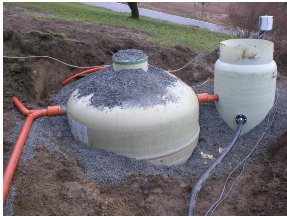
Slamavskiller og støtbelaster (pumpe)
