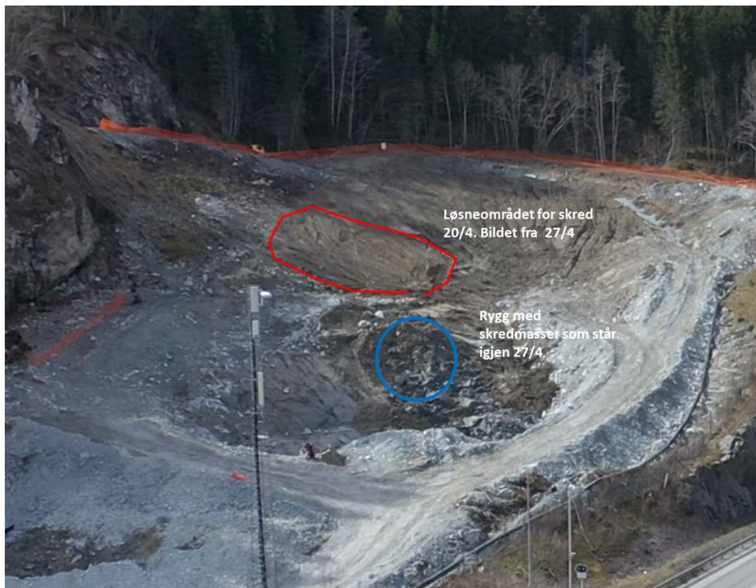
Figur 2-6. Bilde fra anleggsområdet tatt 27. april. Løsneområdet for skredet 20. april er tegnet inn med rød sirkel. Rygg med skredmasser som ikke ble fjernet etter skredet er tegnet inn med blå sirkel. Skredmasser som havnet i utgravd område, ble fjernet 21.-22.april (modifisert bilde fra Nye Veier).
