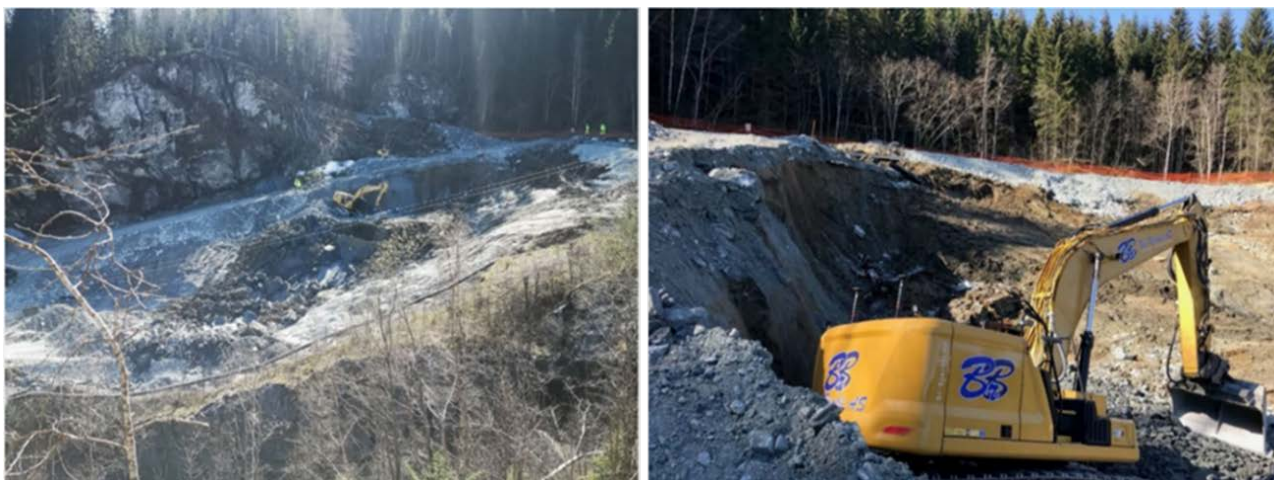
Figur 2-5. Bilder fra skredet 20. april 2022. I venstre bilde vises skredets utbredelse [8], til høyre vises gravemaskinens sluttposisjon [7].
