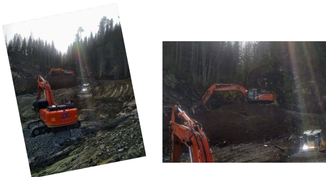
Figur 5-7. Bilder tatt på formiddagen 4. mai (Foto Br. Bjerkli AS). UE graver ned topp av skråning og bulldoser flytter masse mot annen gravemaskin som laster på dumper som kjører masse ut av området.
