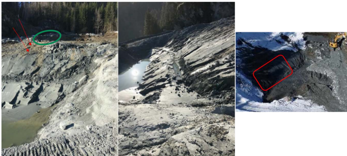
Figur 2-3. Sprekker i skråning nedenfor anleggsveien observert ved befaring 15. april (venstre) (modifisert etter [7]). Området der masser raste ut fra anleggsveien er markert med grønn sirkel til venstre i figuren. Området med sprekker er markert med rødt rektangel i bilde tatt 7. april (høyre) (modifisert etter [7]).
