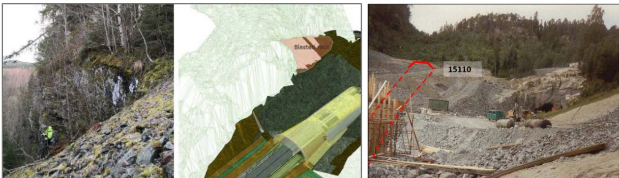
Figur 4-9. Fylling plastret med stein sørøst i anleggsområdet. Venstre: foto tatt vertikalt på fyllingen, med fjellskrent i bakgrunnen [32]. Midten: fyllingen er merket med rosa skravur, eksisterende tunnellop er merket med gul skravur [32]. Høyre: Tunnelpåhugg for eksisterende Stavsjøfjelltunnel vises til høyre i foto av Statens vegvesen fra slutten av 1980-tallet. Rødstiplet linje viser planlagt trasé for nytt tvillingløp [13].
