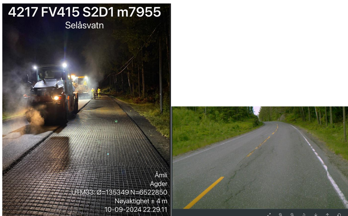
Figur 1 Asfaltering på utlagt armeringsnett til venstre (Ref: bilde i e-post fra Jan Ragnar Finsland) – tilstand i 2023 til høyre
