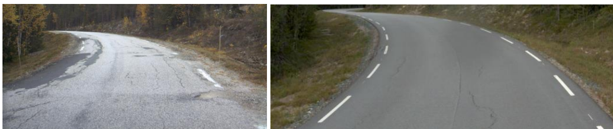
Figur 19 Noen skader observeres i 2025, men hovedsakelig på steder som hadde betydelige skader før tiltak
