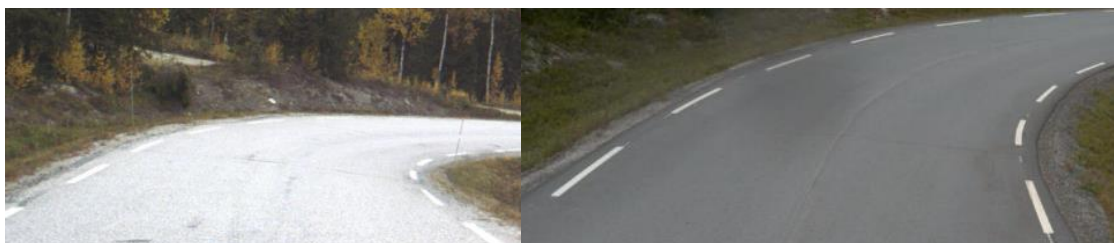
Figur 20 Tversgående sprekk på samme sted før tiltak og i 2025
