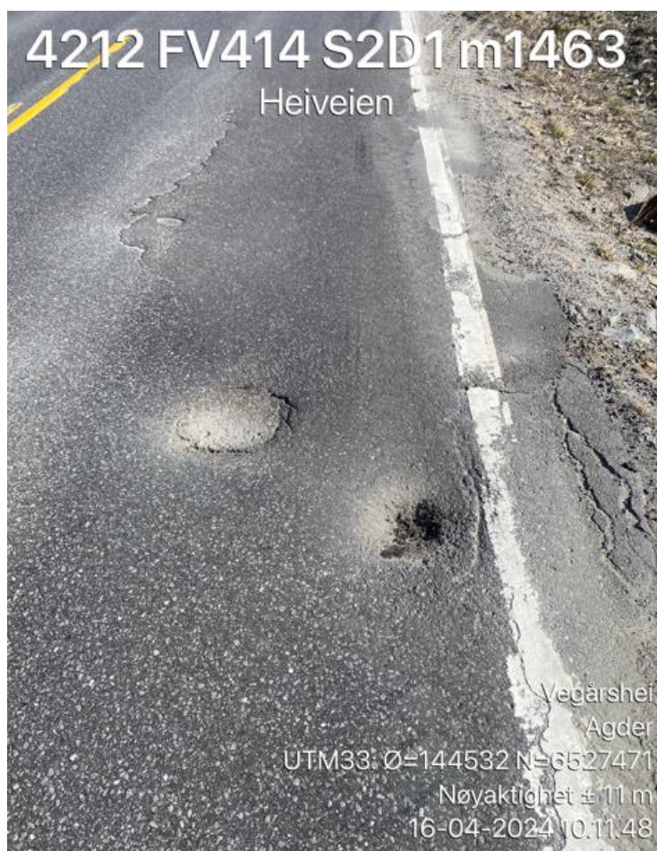
Figur 2 Skader i vegdekket («synkehull») (Ref: bilde i e-post fra Jan Ragnar Finsland)
