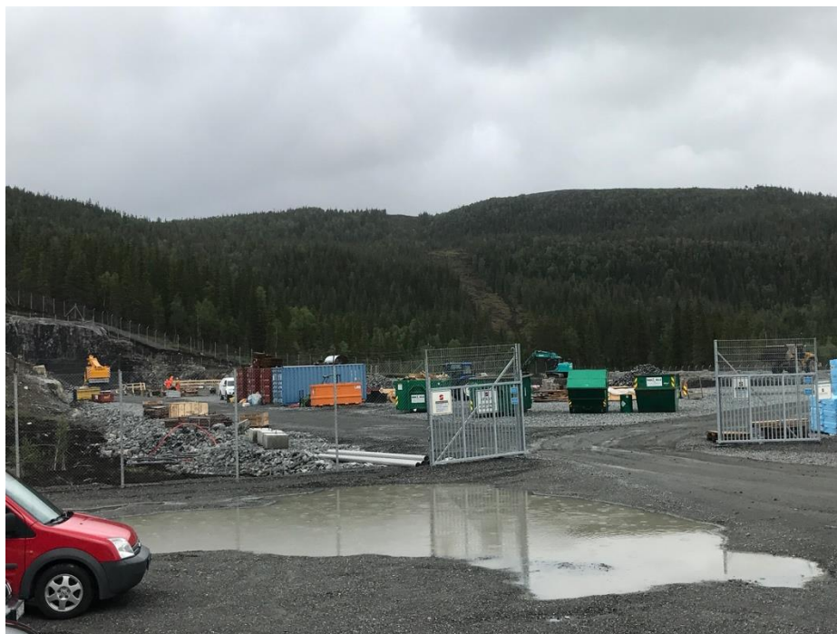
Figur 6. Transformatorstasjonen på Hofstad.
