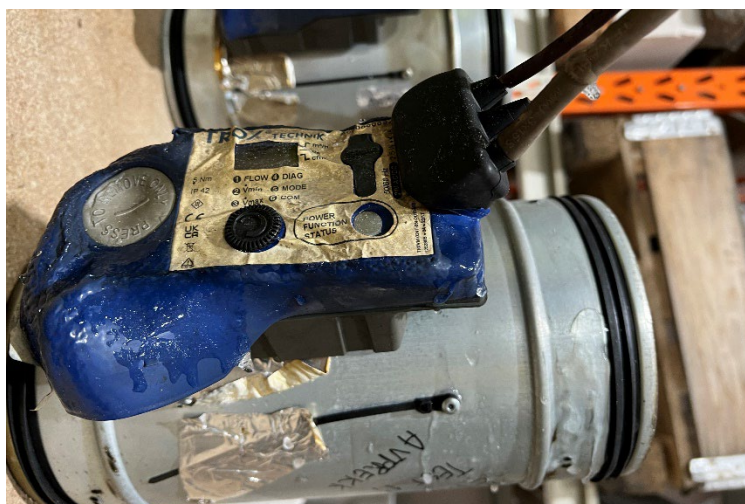
Figur 4-18: Skader på motor og elektronikk på avtrekksspjeld etter test 11.
