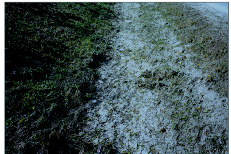
Figur 16. Tilslamming i grøft langs E6 Jessheim N (foto COWI, mai 1994).
