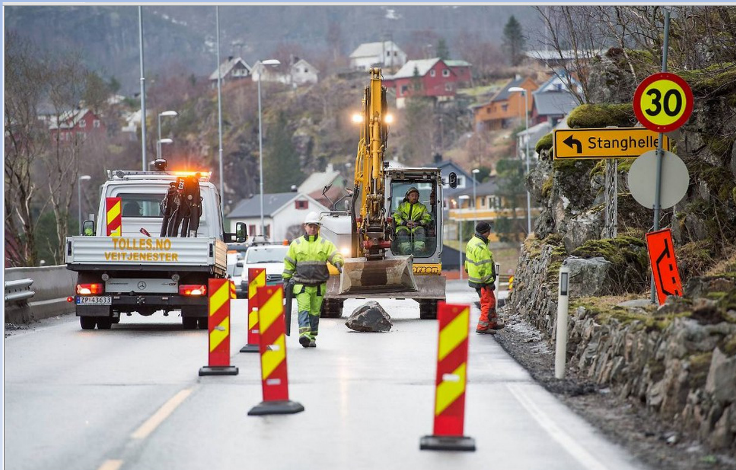
Onsdag ettermiddag ble en bil truffet i siden av en stein som raste ned fra fjellsiden på Stanghelle på E16, det første til at veien ble stengt frem til torsdag formiddag. Mellom 2000 og 1014 gikk det 260 ras på strekningen, og hele 66 ganger ble veien stengt. Det siste året har det også vært gjentatte ras og stengninger. Bergenserne som er blitt spurt i en nylig undersøkelse har en god og trygg E16 høyt oppe på sin ønskeliste. Foto: Eirik Hagesæter
