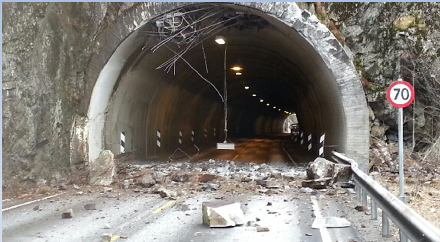
Vaksdal isolert etter to nye ras (04.2013)
