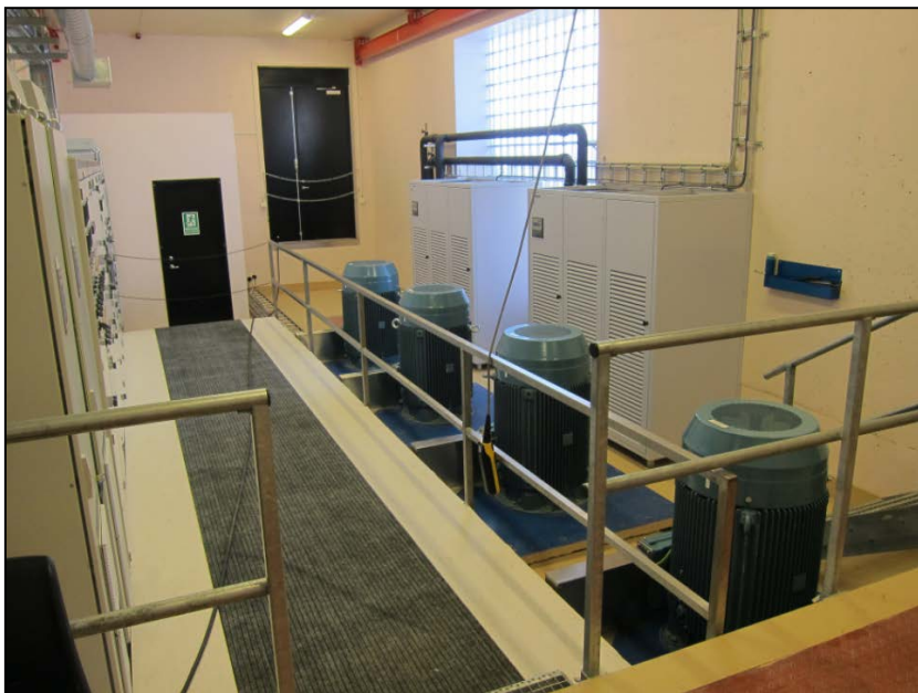
1.etasje: fire motorer
