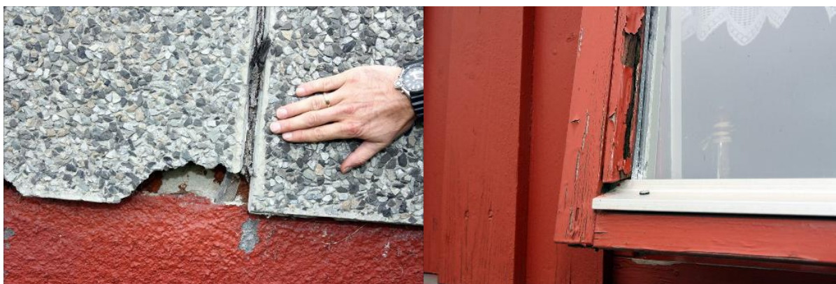
Figur 2: Eksempler: sprekker i fasaden og råte i vinduskarmer
