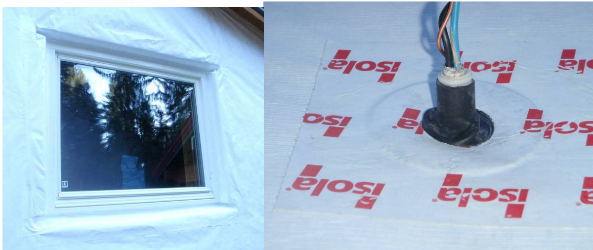
Figur 4: Bildet til venstre viser utviklet tettemetode rundt passivhusvinduer som er plassert mitt i isolasjonssjiktet (fra et annet pilotprosjekt, men med samme isolasjons- og tettemetode planlagt på Myhrerenga). Bildet til høyre viser tetting med nyutviklet mansjettløsning rundt teknisk gjennomføring.
