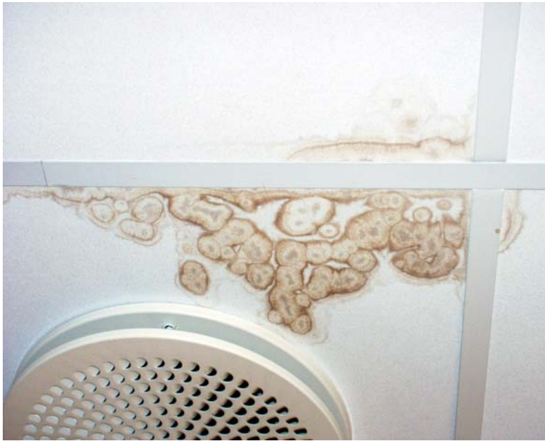
Figur 4: En kortvarig taklekkasje førte til en kraftig misfarging av himlingsplater på grunn av utvasket sot og støv. Det var ingen vekst av muggsopp der, selv om dette ble antatt før prøveanalysen viste at det var i orden.
