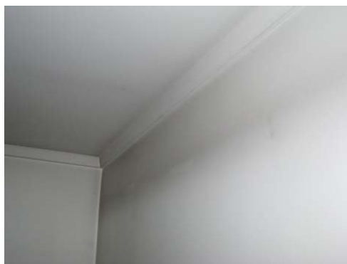
Foto 1. Heksesot – mørk misfarging - er typisk i nye boliger med en noe lav ventilasjonsrate.
