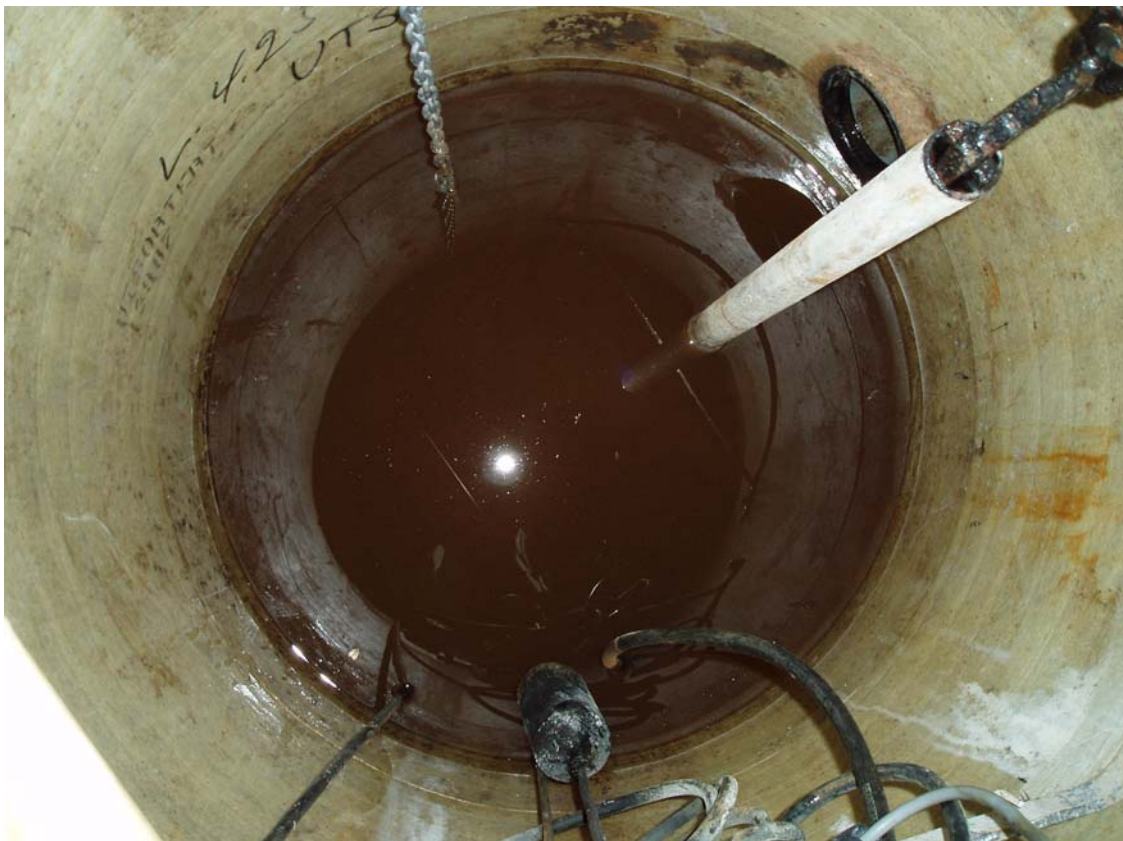
Figur 20. Eksempel på privat avløspumpestasjon innenfor nedslagsfeltet til Svartediket (Foto: Bergen Vann, november 2004)
