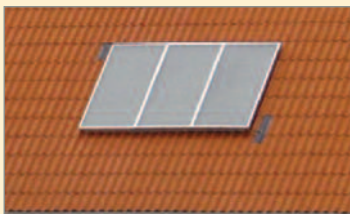
Figur 4.33 Vannbasert solfanger plassert på taket.
