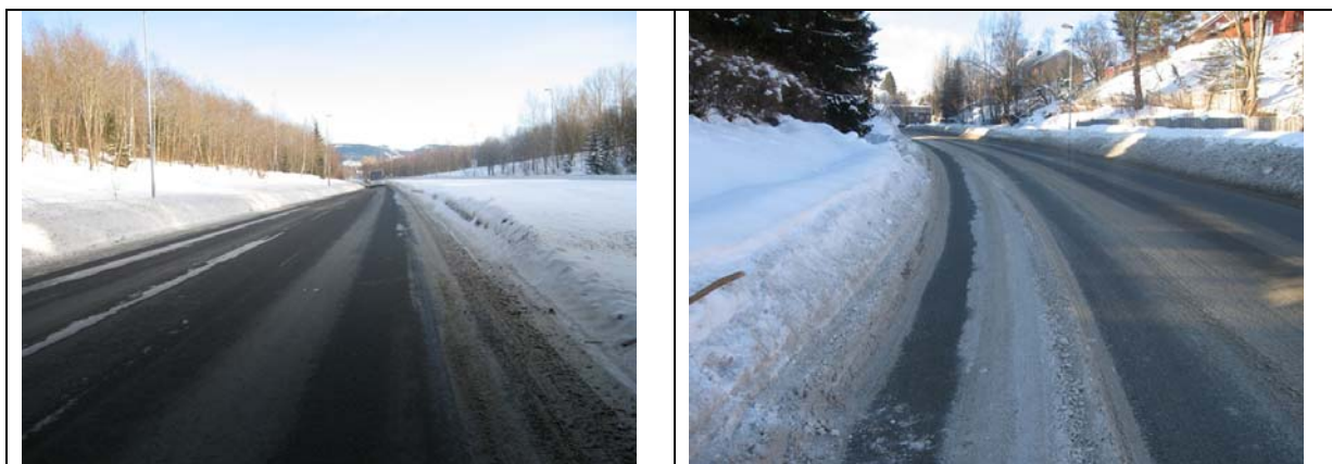
Figur 4.3: Stort sett bart i Kolstadvegen, men sporet veg i Breidablikkvegen
