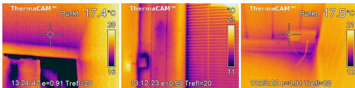
Figur 2 Innvendig termografering indikerer betydelig kuldebro i overgangen mellom taket og sør fasaden (venstre). I overgang mellom gulv og yttervegg ble det også registrert svært lave overflatetemperaturer, spesielt i forbindelse med elektriske koblingsbokser/brytere (midten). Disse lave temperaturene kan ha sin årsak i en kombinasjon mellom kuldebroer og utettheter i forbindelse med innspenn mellom innervegg-yttervegg/gulv-yttervegg, samt de elektriske installasjonene.
