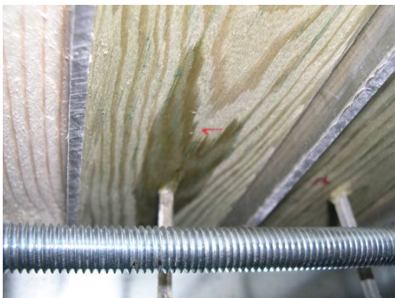
Figur 14 Fuktflekk ved håndspiker i trykkimpregnert materiale
