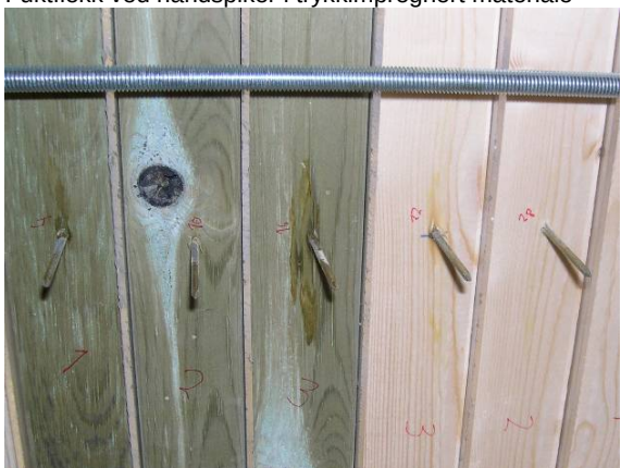
Figur 18 Fuktflekker i trykkimpregnert og ubehandlet trevirke
