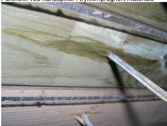
Figur 16 Fuktflekk ved håndspiker i trykkimpregnert materiale
