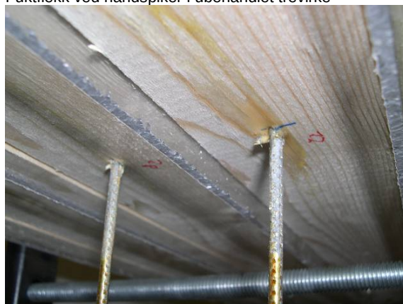
Figur 17 Fuktflekk ved maskinspiker i ubehandlet trevirke
