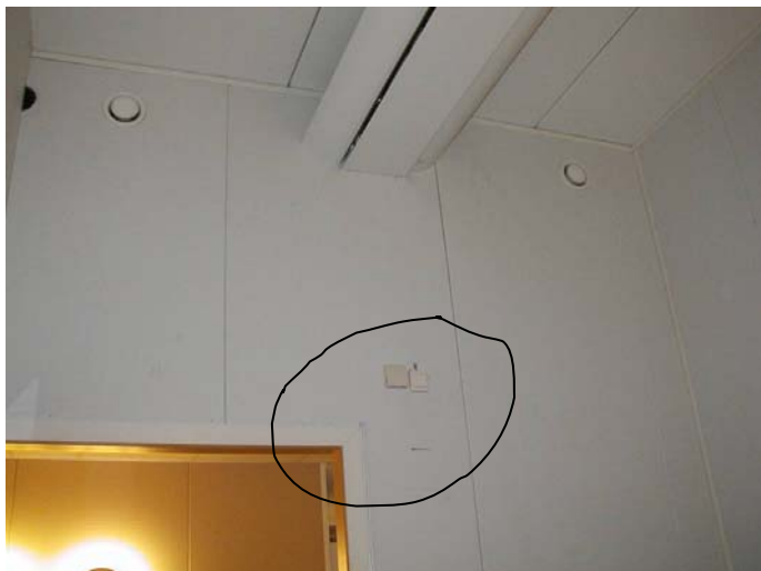
Figur B-11. Plassering av termostats og bevegelsessensor over døren på vegg mot korridor - Cellekontor (Foto: SINTEF Byggforsk/ Catherine Grini)
