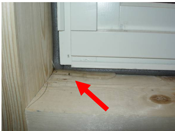
Figur 3.4.3. Bunnfyllingslist sett innenfra, lekkasje i underkant vindu
