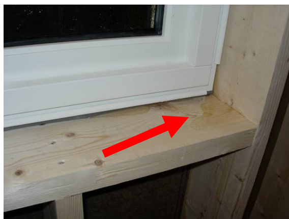
Figur 3.3.4. Vannlekkasje i underkant vindu
