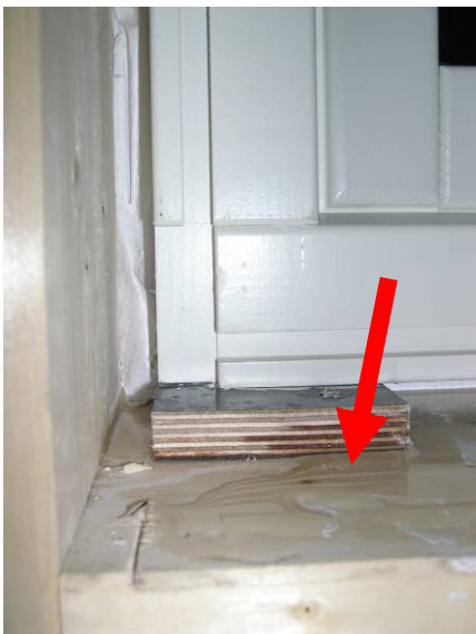
Figur 3.5.3. Vannlekkasjer ved hjørne og i underkant vindu
