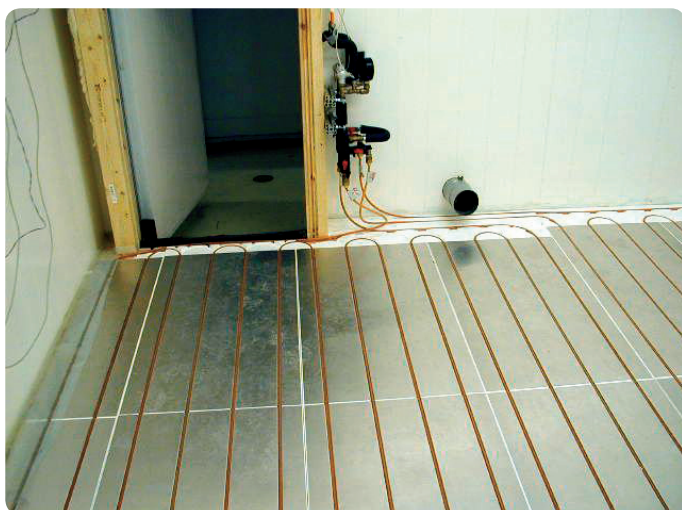
▲ Dokumentasjon av et gulvvarmesystem
